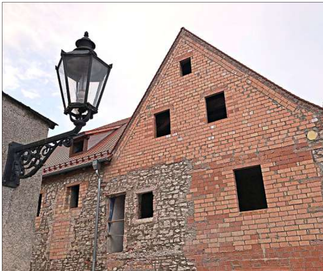
Die Sanierung der Fronfeste ist in Burglengenfeld ein Dauerthema. Auch in diesem Jahr wird dafür eine Stange Geld zur Verfügung gestellt, nämlich rund 265 000 Euro. Fotos: Thomas Rieke
