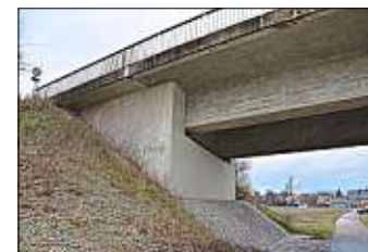
Die Sanierung der Naabbrücke findet auch 2025 nicht statt.
